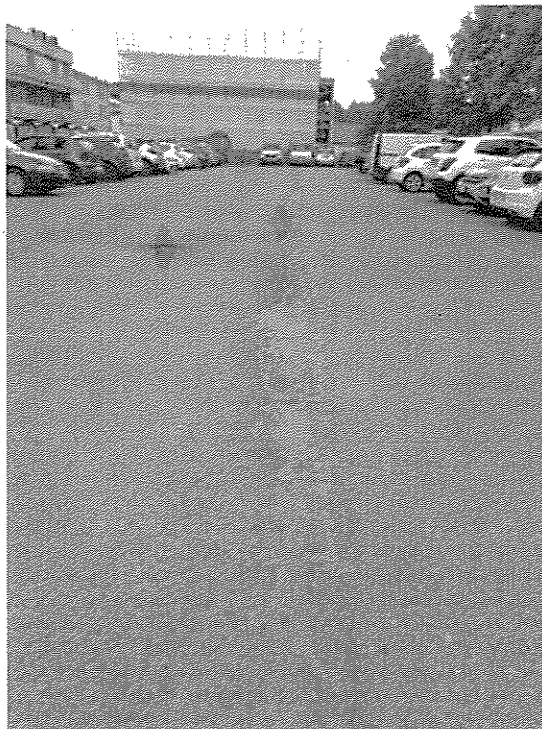
Piazzale Croce Rossa (asfalto da sistemare)
