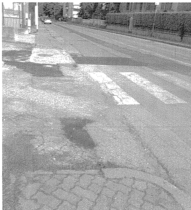
Via Fenoglio angolo via Bodina (marciapiede ammalorato)
