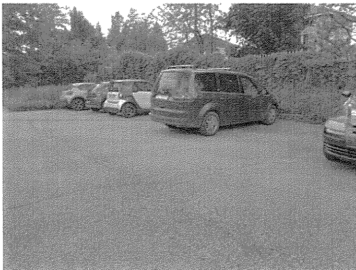
Piazzale Croce Rossa (mancanza segnaletica orizzontale)
