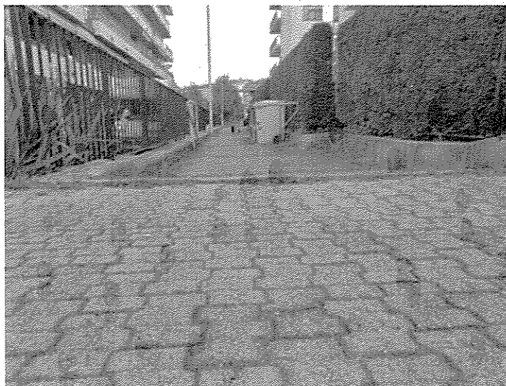
Passaggio tra Via Vinaj e via Fenoglio (gradino difficoltà per disabili e passeggini)
